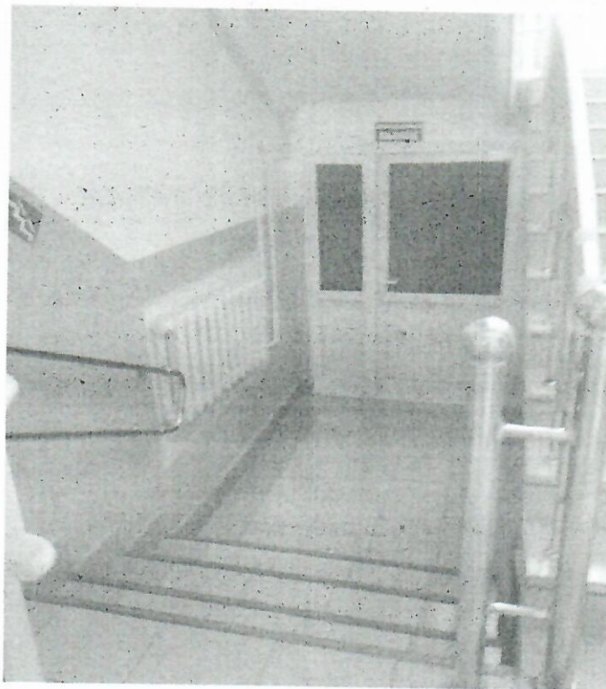
Фото №10. Запасной выход из здания КГБОУ ШИ 2 с западной стороны (вид внутри здания), оборудованный двойными поручнями.
